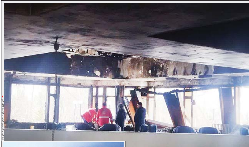
تصویری از فضای داخلی رستوران آتش‌سوزی که در آن سقف و دیوارها آسیب دیده است.
