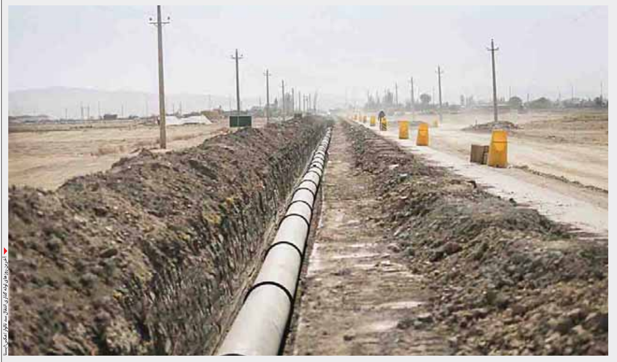
لوله‌گذاری خط انتقال آب از تالوار در بخش اصلی و بای‌پس به پایان رسیده و مراحل نهایی نصب شیرآلات و تست هیدرولیک در حال انجام است.
